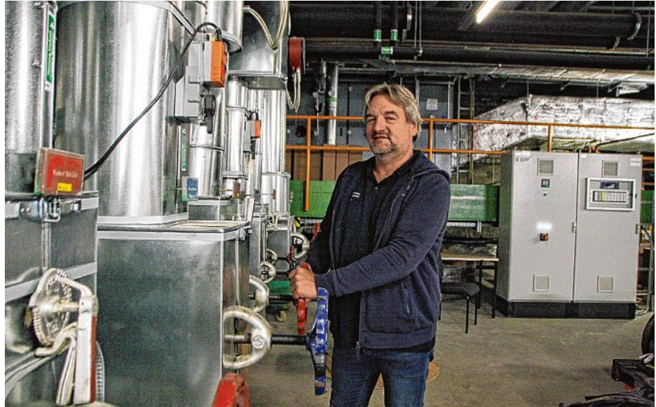
Tilo Prautzsch steuert auf das Ziel einer Universität zu, die weniger Energie als bisher verbraucht. Er ist der Manager, der sich um die insgesamt 40 Gebäude der Hochschule kümmert. BILDER: CLAUDIA RINDT
