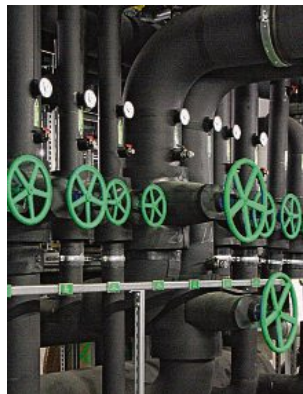
In diesen Rohren fließt Bodenseewasser, das zur Kühlung der Räume an der Universität Konstanz eingesetzt wird.
