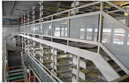
Bald ist auch der Buchbereich BG der Uni-Bibliothek fertig saniert. Die Regale stehen schon wieder weitgehend, jetzt laufen Arbeiten an der Sprinkleranlage. BILD: UNI KONSTANZ
