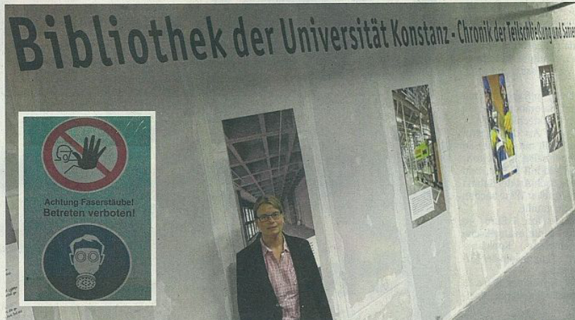
Uni-Pressesprecherin Julia Wandt vor der Chronik der Teilschließung am ehemaligen Haupteingang der Bibliothek. In Bereichen, in den Asbest verbaut wurde, befinden sich Warnhinweise (kleines Bild). Bilder: gemp
