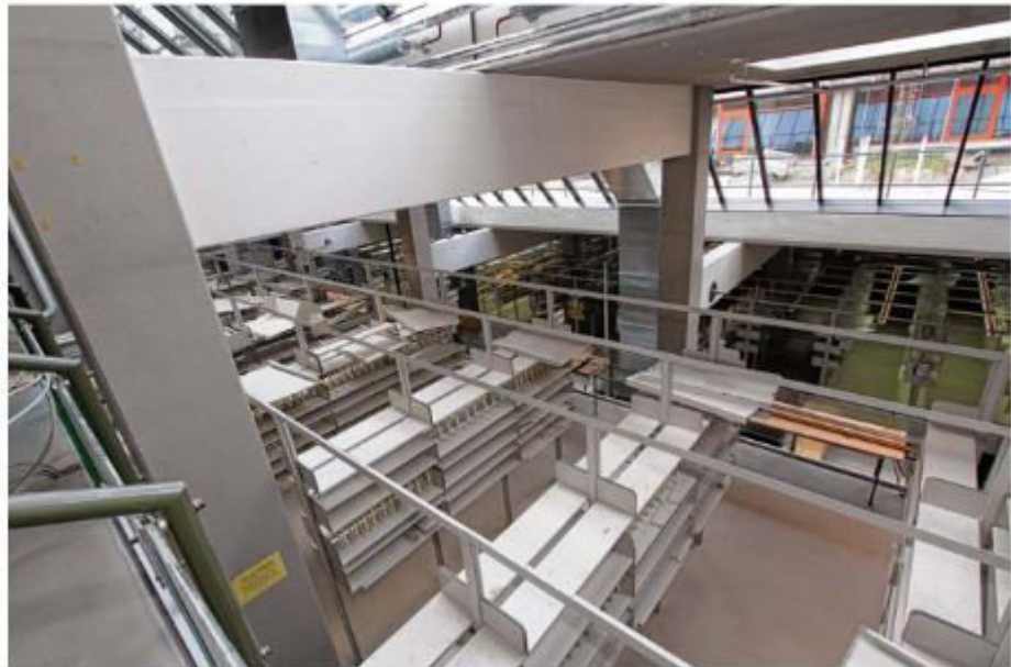
Der Tausendfüßler ist leer: Diesen Spitznamen hat das große Regal der Konstanzer Universitätsbibliothek. Seit der Schließung wegen Asbestlunden wird gereinigt und saniert. Immerhin: Finanzierung und Zeitplan sind nicht gefährdet, sagen die Verantwortlichen. ANZEIGER
