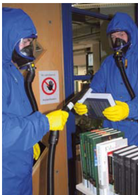
Asbest in der Konstanzer Universitätsbibliothek: Die Bücher werden gereinigt, die Räume ab Frühjahr 2012 komplett saniert.
